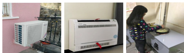
(a) 热风机室外机 (b) 热风机室内机 (c) 生物质炉具
